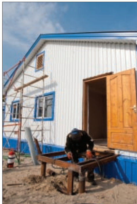
Новый опорный пункт для сотрудников КНС-2 Аганского месторождения. Строители завершают наружные работы
