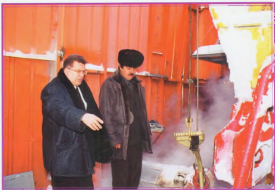
Главный исполнительный директор ОАО «СН-МНГГ» О.В. Пузанов и главный механик общества С.И. Иваницкий на монтаже новой буровой
